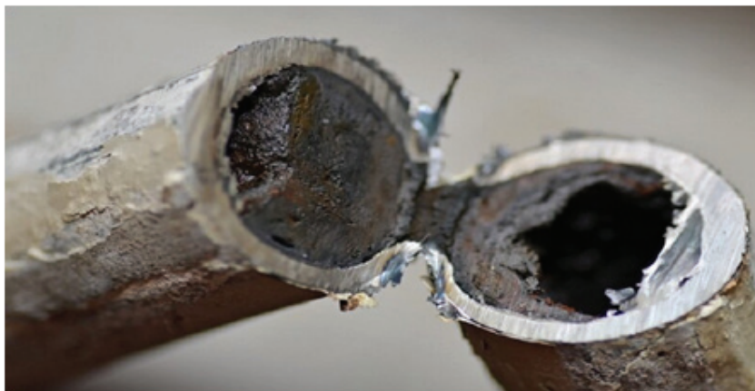
Рисунок 1 - Загрязнение в трубе (стволе скважин)
