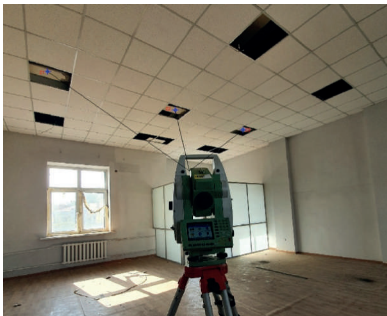
Рисунок 2– Геодезические измерения балок при помощи электронного тахеометра Швейцарской фирмы «Leica Geosystems» серии TC1201+
