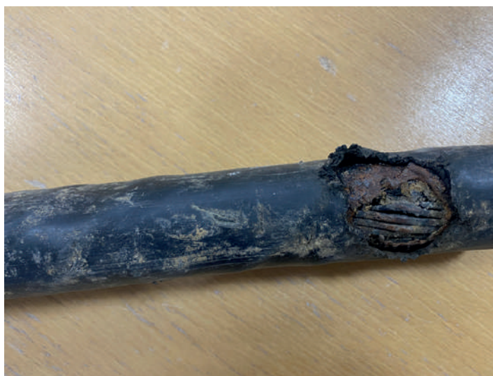
Рисунок 3 - Кабель, поврежденный в результате земработ
